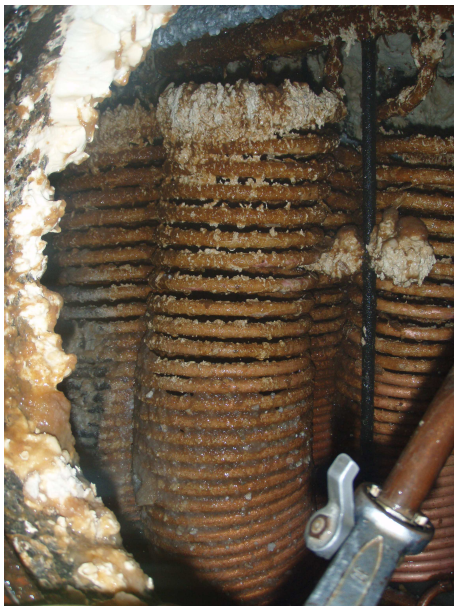
Varmespiraler i en stor urensset VVB med kalkbelægning og termofile slimbakterier
