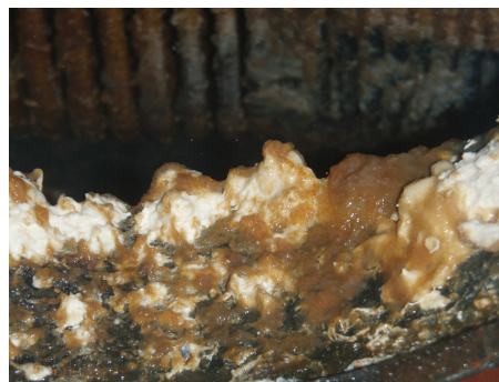
Kalkbelægning med slimbakterier i en urensset VVB
