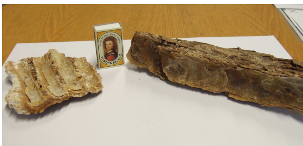
Kalkbelægnings-skaller fra en rensset varmespiral
